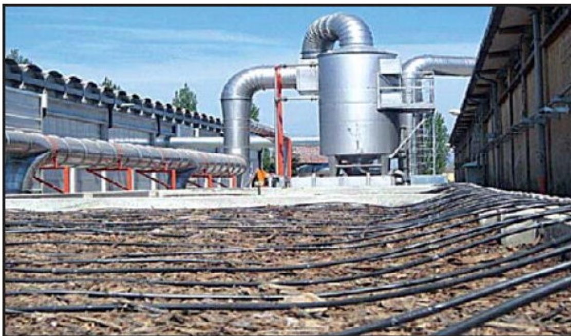
Un moderno impianto di compostaggio
