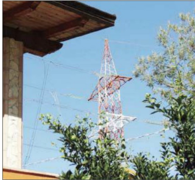
Uno dei tralicci dell'elettrodotto
