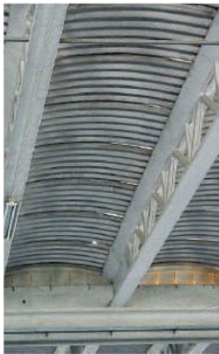
La copertura. L'amianto è a vista
