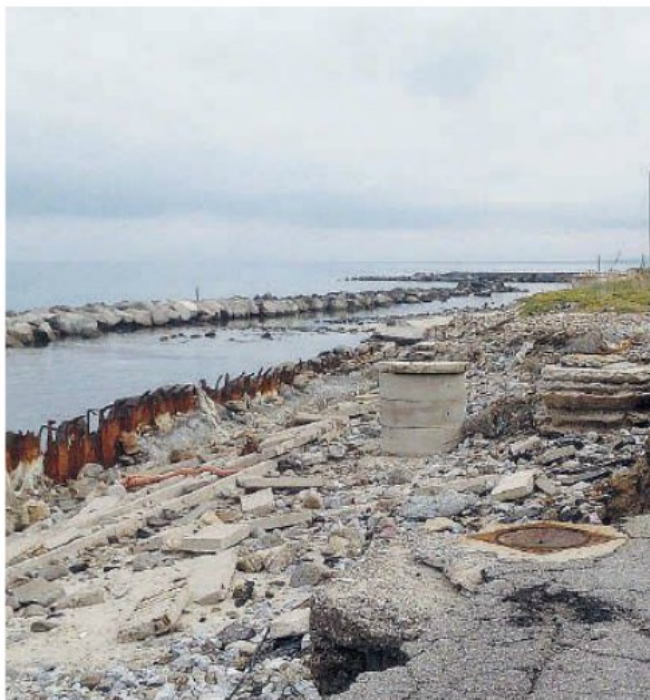
Il rischio. Di recente un ulteriore crollo ha collassato un altro tratto di lungomare
