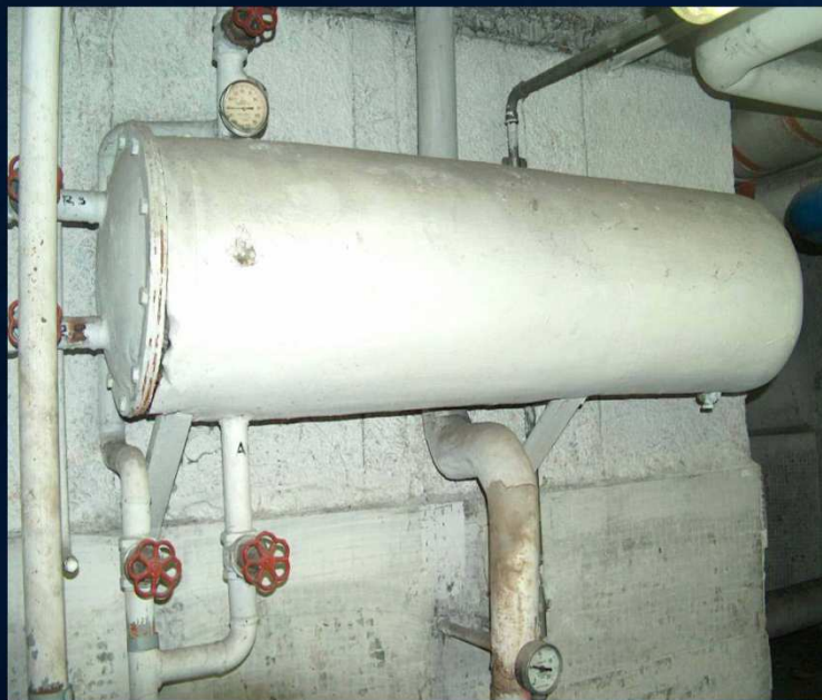
Cisterna coibentata in MCA presente in centrale termica
