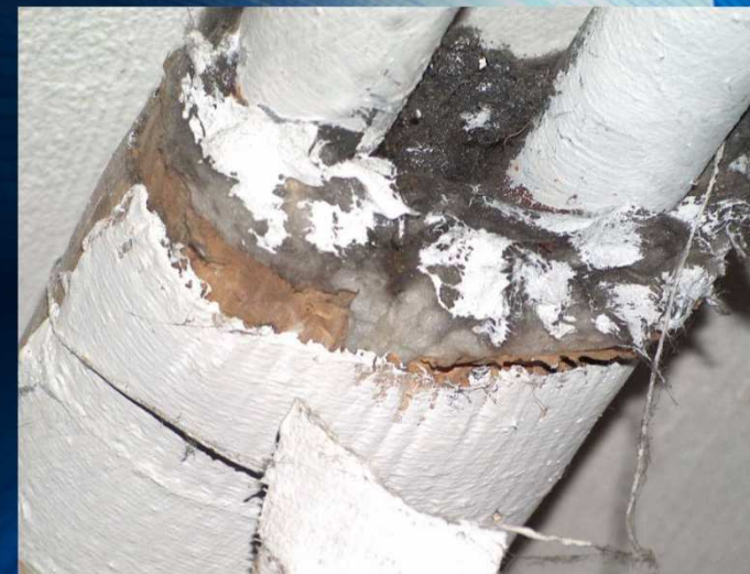
Tubazioni a soffitto coibentate con lane minerali, cartone ed intonaco in MCA
