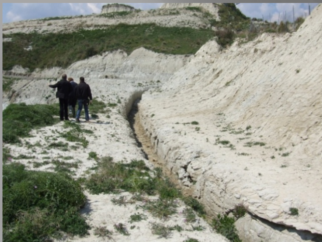
Canale di raccolta acque di precipitazione
