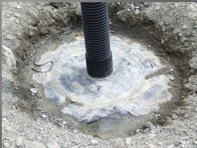
Pozzetto per lo sfiato del biogas
