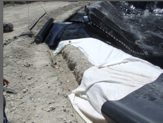
Particolare del geotessile e della geomembrana
