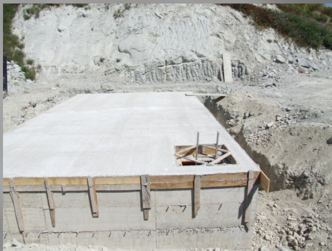
vasca raccolta percolato in cemento
