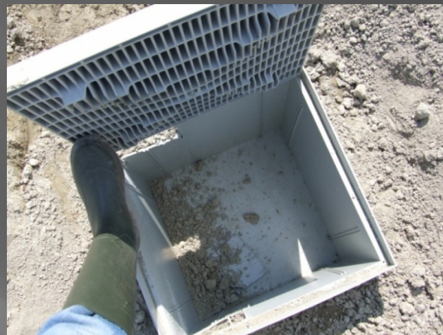
Pozzetto per il controllo delle acque di ruscellamento superficiale
