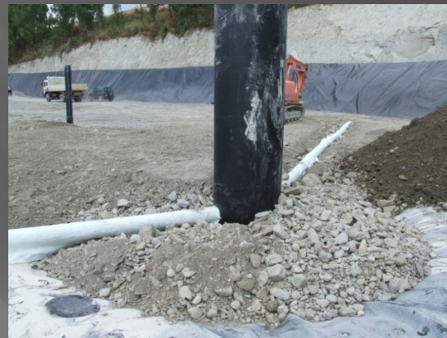
Pozzo di raccolta del percolato
