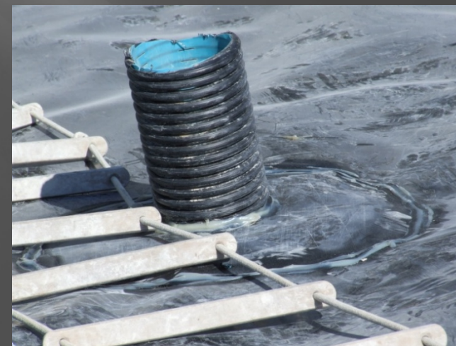
Pozzetto per lo sfiato del biogas nella parete laterale
