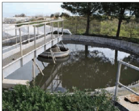
Una vasca di depurazione
