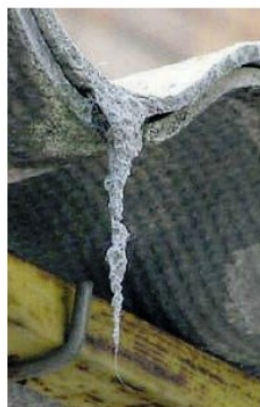
Amianto. Le lastre di eternit contengono il dannoso materiale
