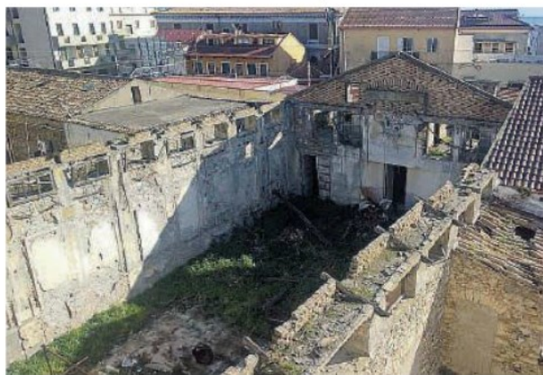
Degrado. La struttura dell'ex cinema Orso nel quartiere marinaro
