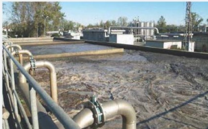
Un impianto di depurazione
