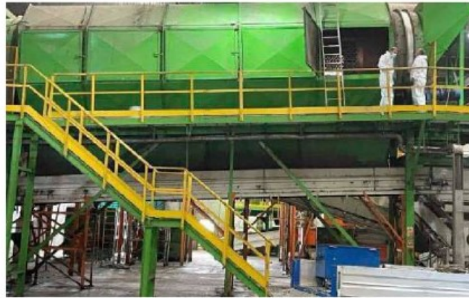
Il selezionatore Un guasto al vaglio principale impedisce la piena operatività
