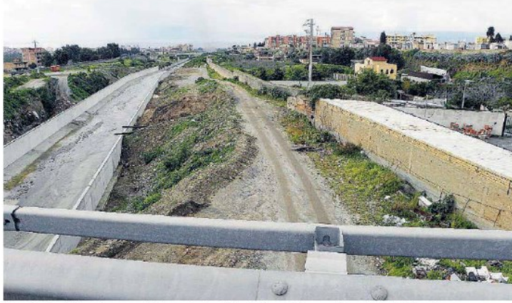
Area da bonificare La zona del torrente Sant'Agata da anni in completo stato di abbandono
