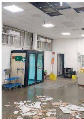
Crollato Il contro-soffitto dell'ufficio postale di Isola Capo Rizzuto
