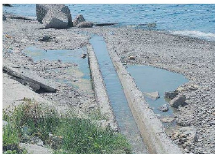
Scarichi Una fuoriuscita di fogna nella zona della Capannina
