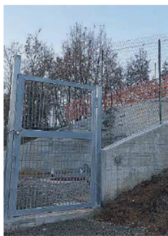
La recinzione i lavori in via Savinio viaggiano in maniera molto spedita
