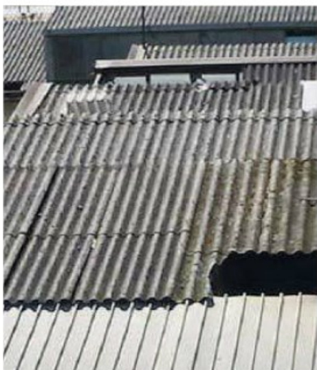
Eternit Una vecchia copertura può diventare un pericolo
