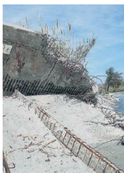
In rovina Quel che resta di un depuratore abbandonato
