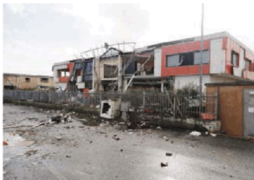
I danni all'Unieuro e, a lato, la tromba d'aria
