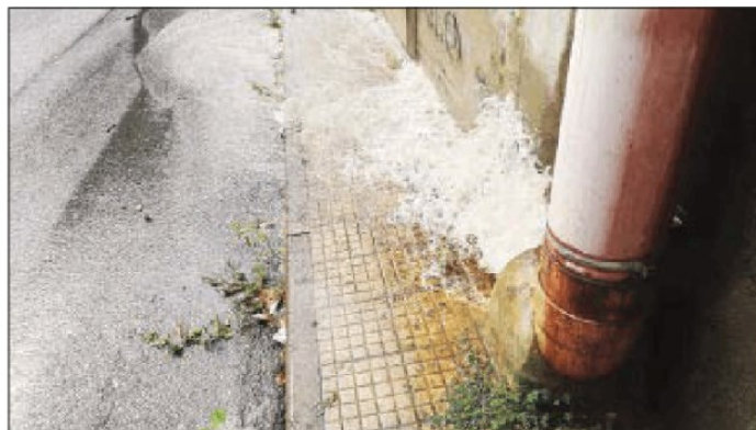
Liquami fognari scaricati dalle tubature
