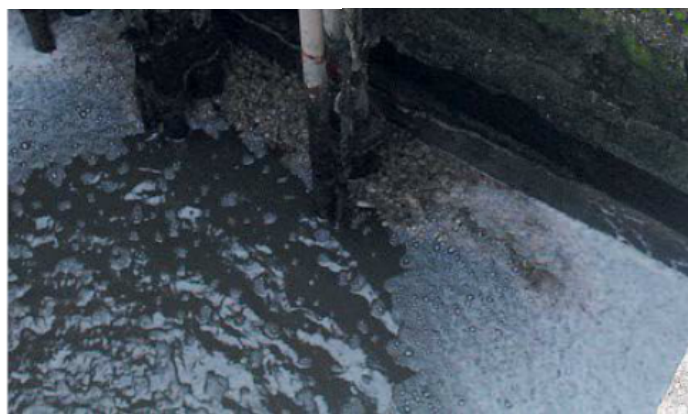
La deregulation. Il bypass illegale realizzato all'interno di una vasca
