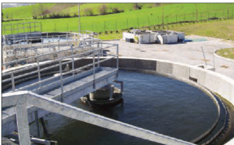
Una immagine del depuratore di Belvedere Marittimo
