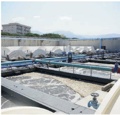
Da rimodernare Alcune vasche del depuratore di Ravagnese
