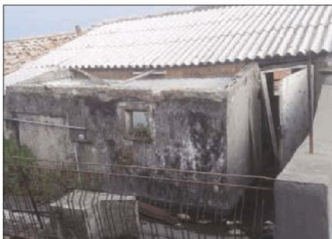
La copertura di eternit della casa "incriminata"
